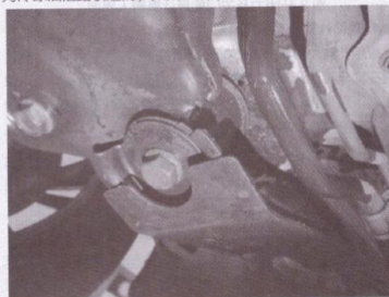
图 2 冷冻油泄露痕迹
